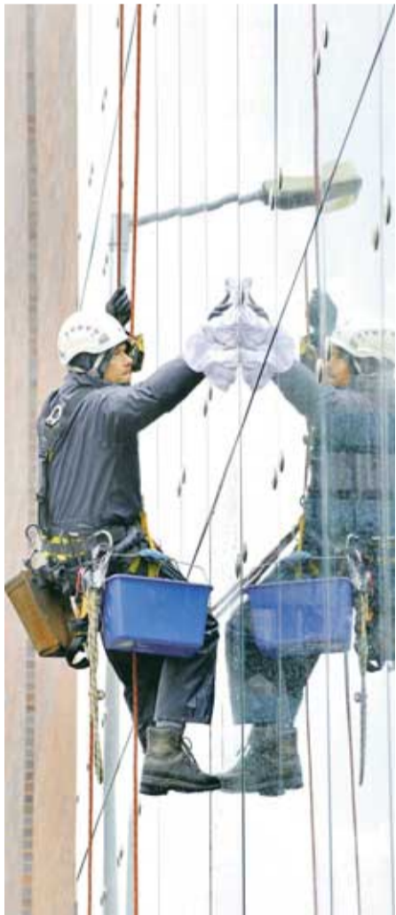
Solistisch: Höhenarbeiter Sven Müller aus Halle am Haus des Buches in Leipzig.
